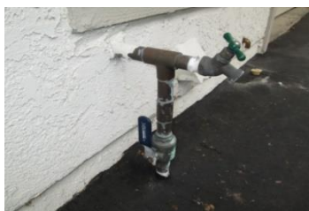
止水栓が開いている (レバーが地面に垂直)
