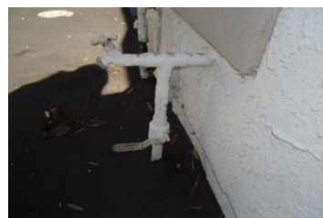
止水栓が閉じている (レバーが地面に平行)
